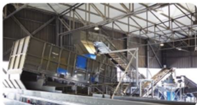
Impianto di selezione rifiuti plastici e misti 15.01.02 - 15.01.06 con tecnologia Industria 4.0
